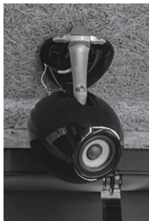
▲サラウンドスピーカーもイクリプスのTD307MK3。リスニングポイントに向けて角度調整済み。配線はすべて壁、天井内に隠蔽されており、このあたりの納置を仕上がりガインストーラーの技だ
