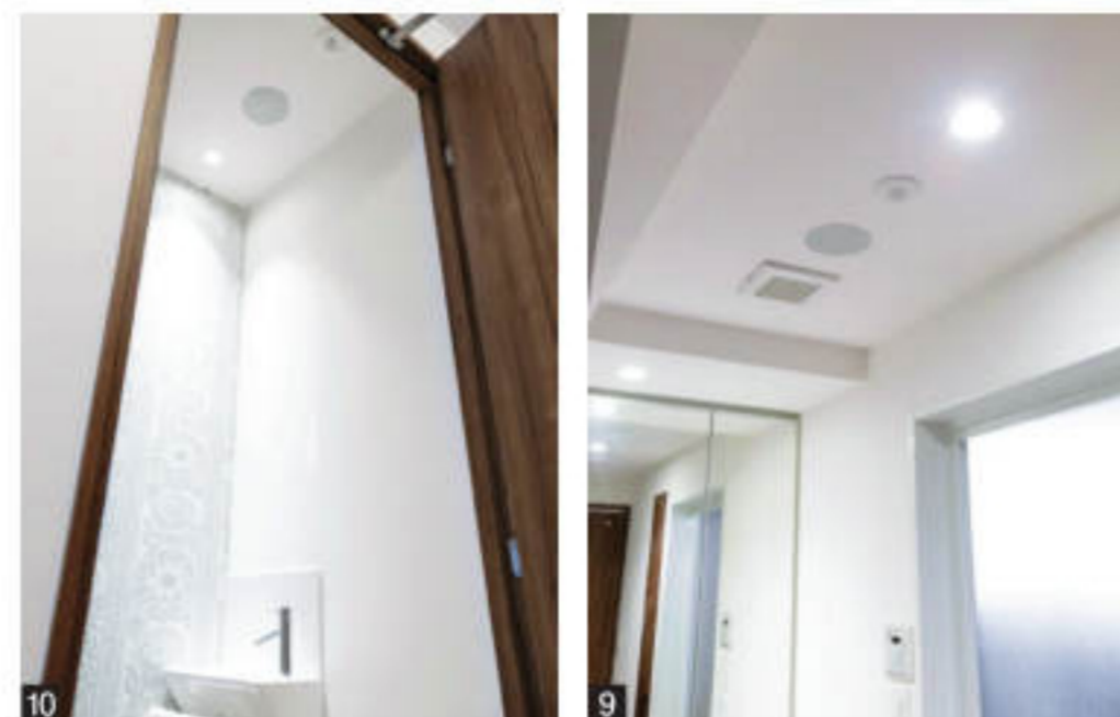
9 脱衣所にはスピーカーを埋め込み、人感センサーで人が入ってくるとBGMが自然と再生されるように設定されている。10 写真はトイレの天井の様子。こちらの機能も脱衣所と同様。
