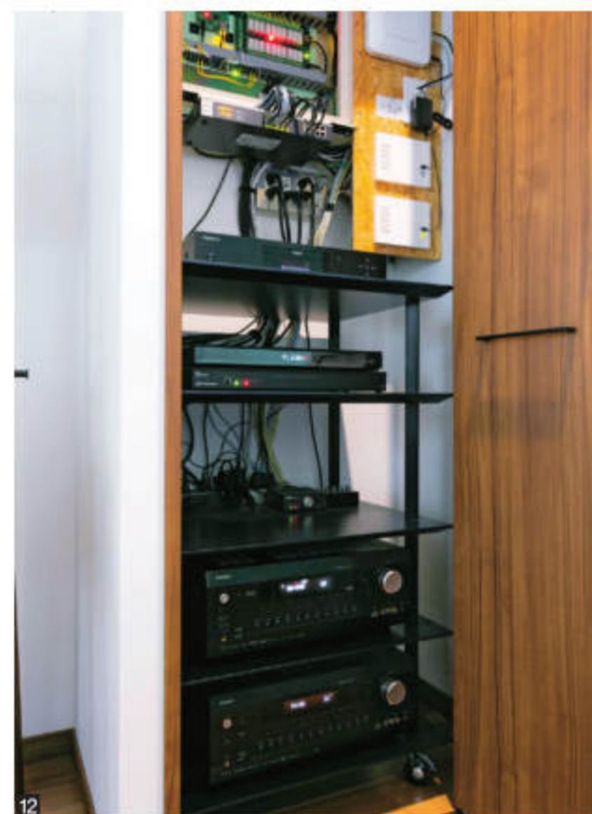
12 ホームシアター機器や制御機器などは、マシンセクションを設けて管理している。機器の追加などがあつた場合も対応できるように、オートメーション機器には余裕を持たせているという。
