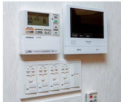
▲照明を含むオートメーションシステムの構築も木田電業が得意とするところ。だが、あえてアナログでわかりやすさ志向のスイッチ類を配置。あくまでユーザーの気持ちや波むがゆえのセレクトだ
